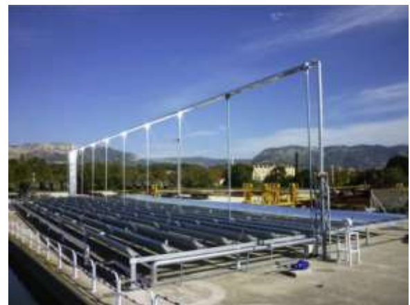
Fig. 5: LFR power plant, [28].
